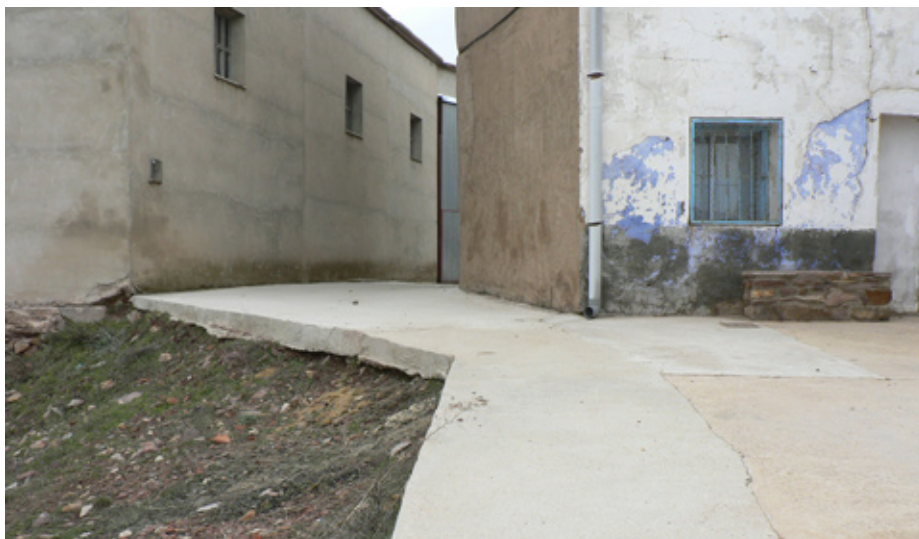
Paso peligroso que se va a mejorar, con una ampliación de la calle.
