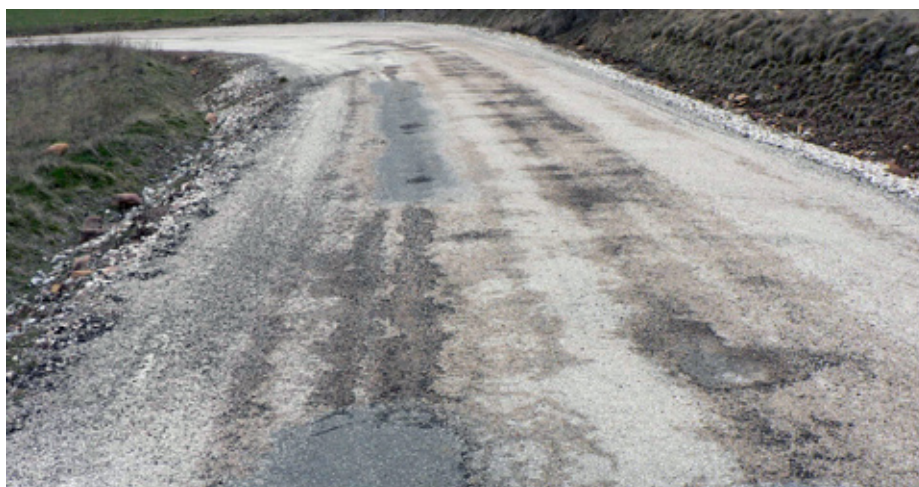
Aspecto de la carretera, con numerosos baches y mucha grava suelta.
